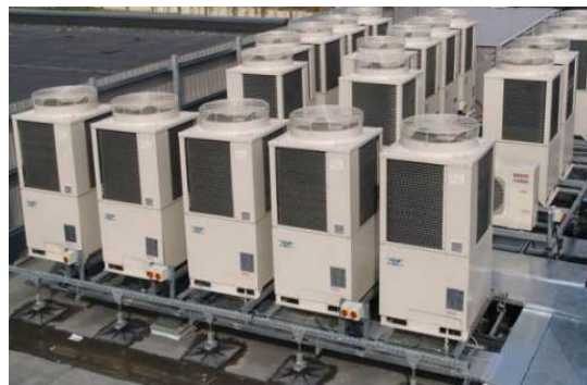
Hình 2. Cụm dàn nóng của hệ thống VRV
