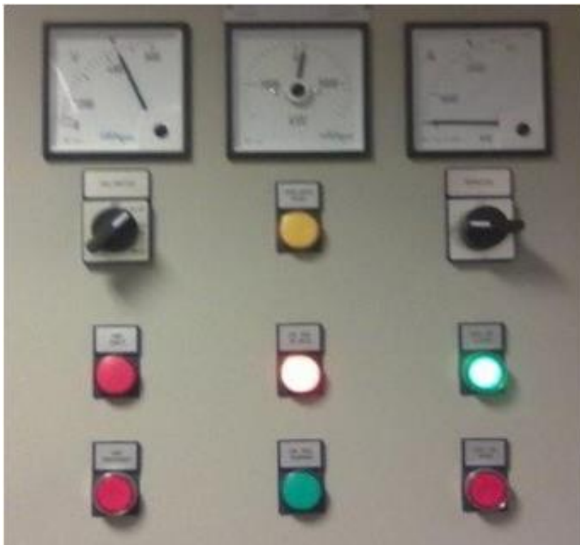
Hình 2.1 Bảng điều khiển máy phát khẩn cấp
